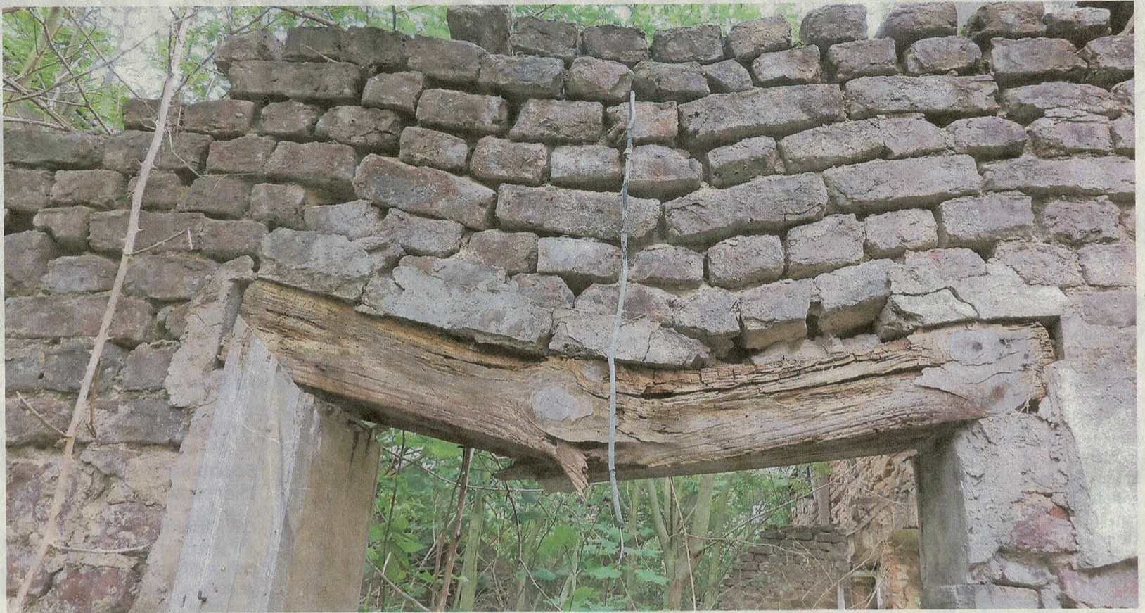
Der Balken unter dem Türsturz biegt sich bedenklich weit durch. „Durch Feuchtigkeit wird das Holz irgendwann morsch und bricht durch“, sagt Michael Hündgen.
