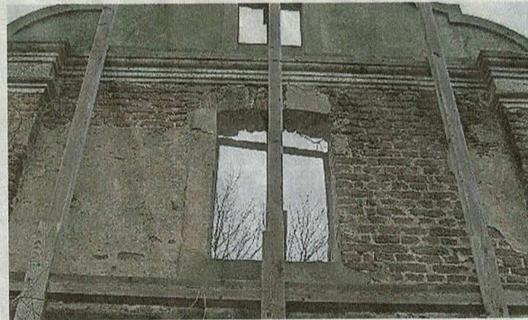
Die Remise kann durch die Holzpfeiler nicht zur Seite fallen, jedoch womöglich in sich zusammenbrechen.
