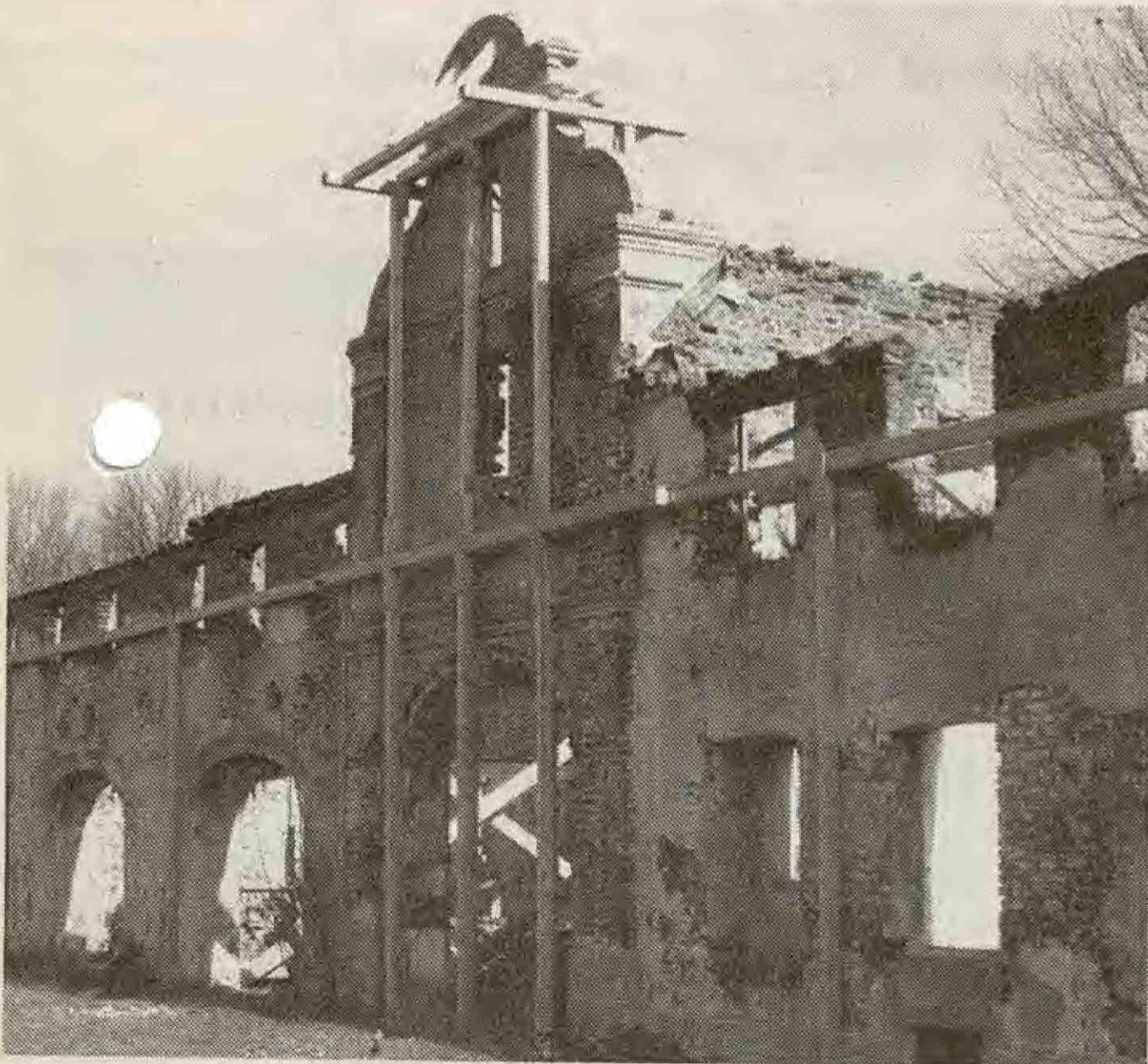
Die Remise muss dringend saniert werden.
